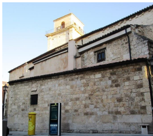
Sta. María; zona del antiguo archivo de la villa con el escudo de los Tellez Girón
